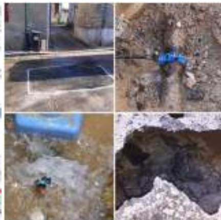
Figures 2 à 5 : Fuite détectée
