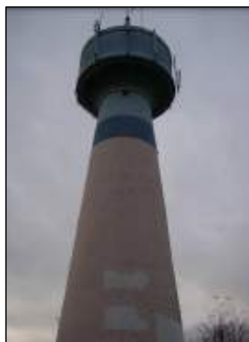
Réservoir de Courdimanche 250m 3
