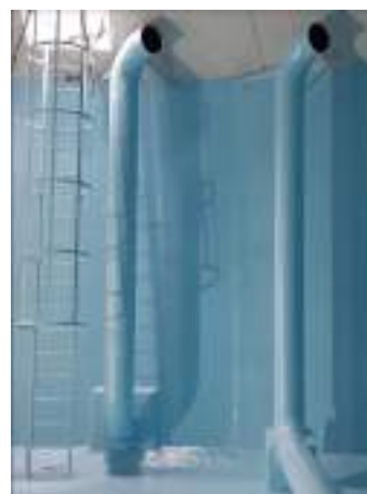
Etanchéité interne cuve n°2 Boisemont 2x4000m3
