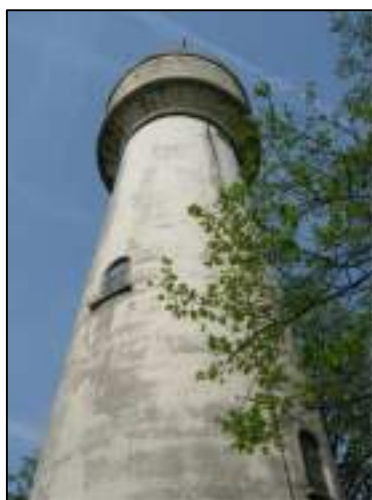
Réservoir de Boisemont 75m 3
